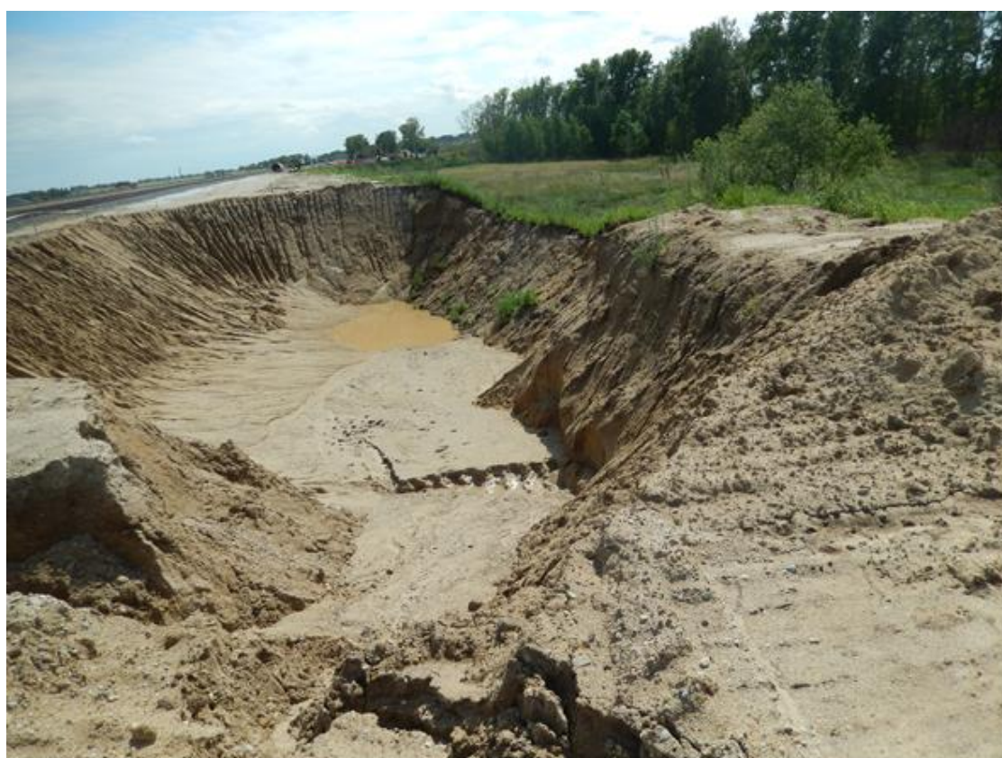
Рис. 32. Дождевая эрозия на склонах
