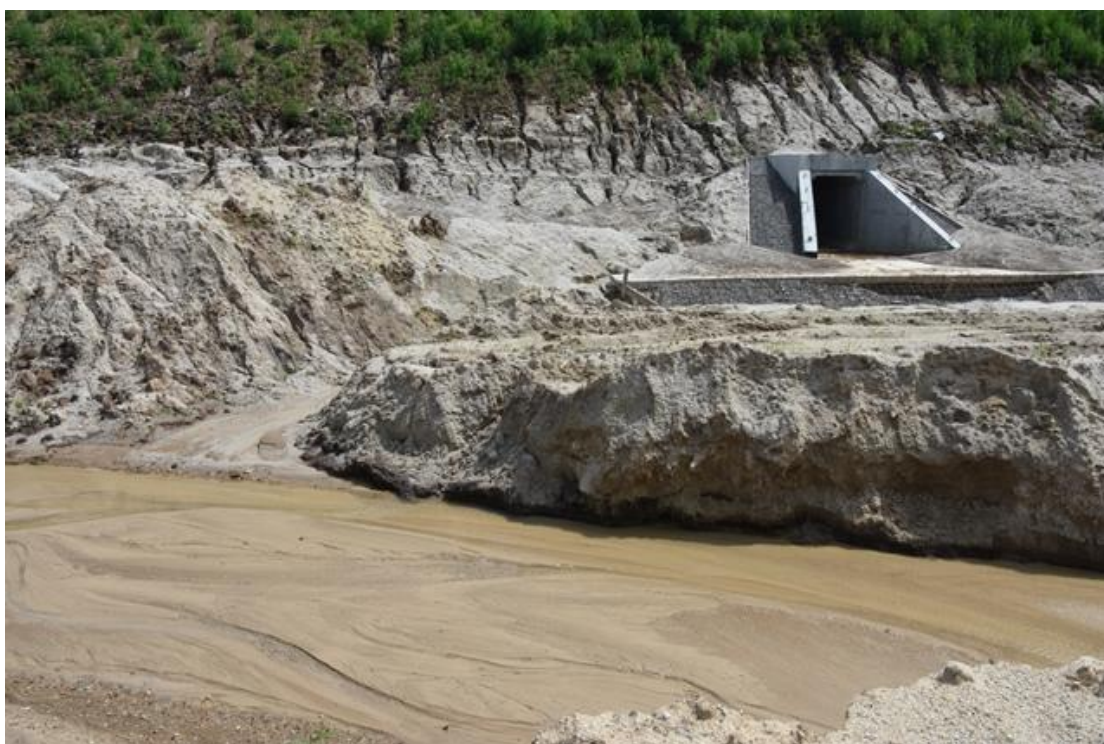
Рис.30. Дождевая эрозия на склонах вблизи конструкций и сооружений.
